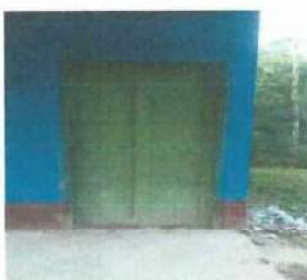
Foto 5: Cambiar puertas de madera a metal
